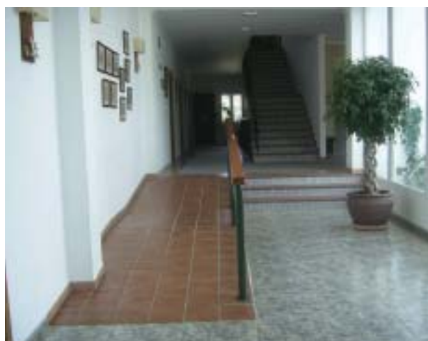
Ejemplo de rampa de suave pendiente construida para salvar 3 escalones. Debe complementarse con un bordillo lateral y dobles pasamanos a ambos lados, prolongados al principio y final de la rampa
