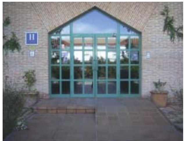
Ejemplo de escalón de acceso a Hotel salvado mediante rampa. Sería conveniente instalar en la rampa un doble pasamanos a ambos lados
